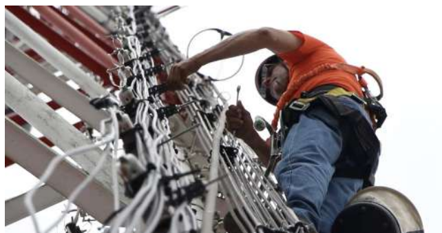
Nuestro técnico de +Móvil haciendo mantenimiento de la conexión telefónica y de banda ancha en Panamá.
